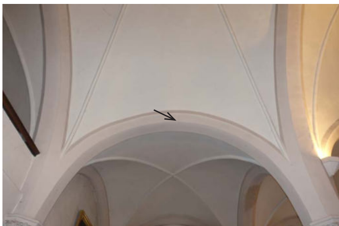
Travée Ouest - Fissure de la voûte entre nef centrale et bas côté Nord
