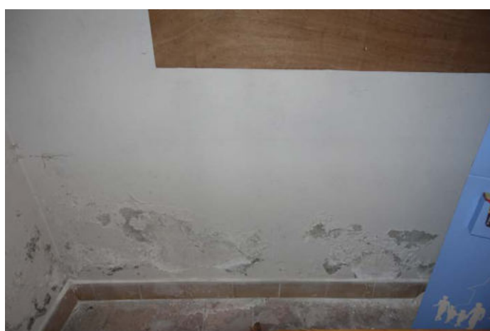
Porche d'entrée - Pied de mur Nord Enduit pulvérulent, remontées capillaires
