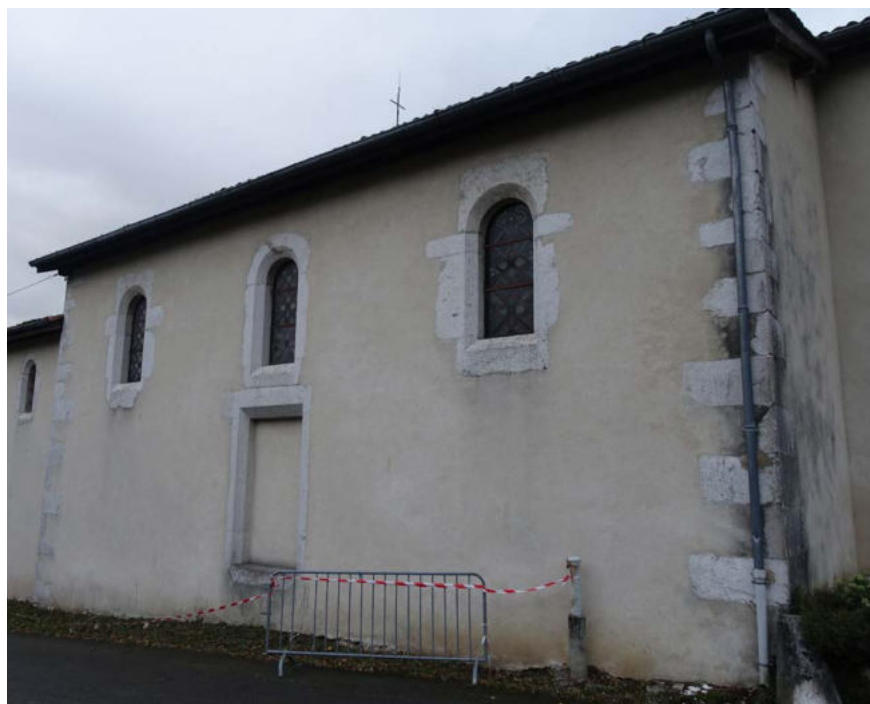
Façade Nord - Bas-côté Nord Remontées capillaires, forte humidité dans l'angle Nord-Ouest
