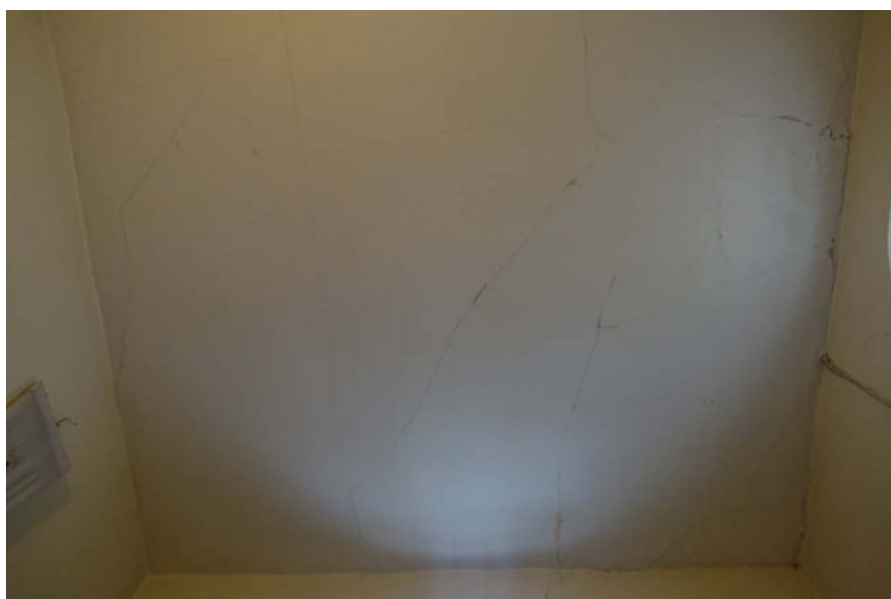
Sacristie, plafond - très fortement fissuré
