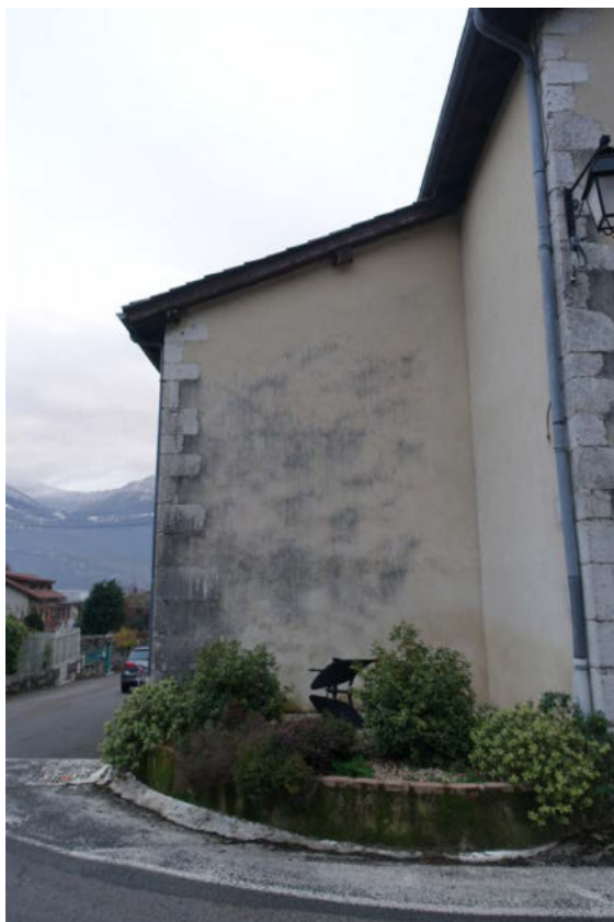
Façade Ouest - bas-côté Nord Taches et importantes remontées capillaires
