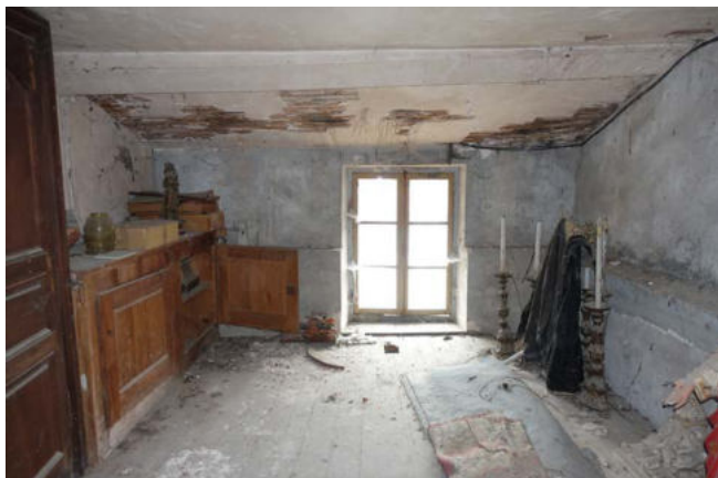
Étage du chœur - mur Nord Surélévation ? enduit ciment, plafond en lattes très dégradé, plancher bois dégradé
