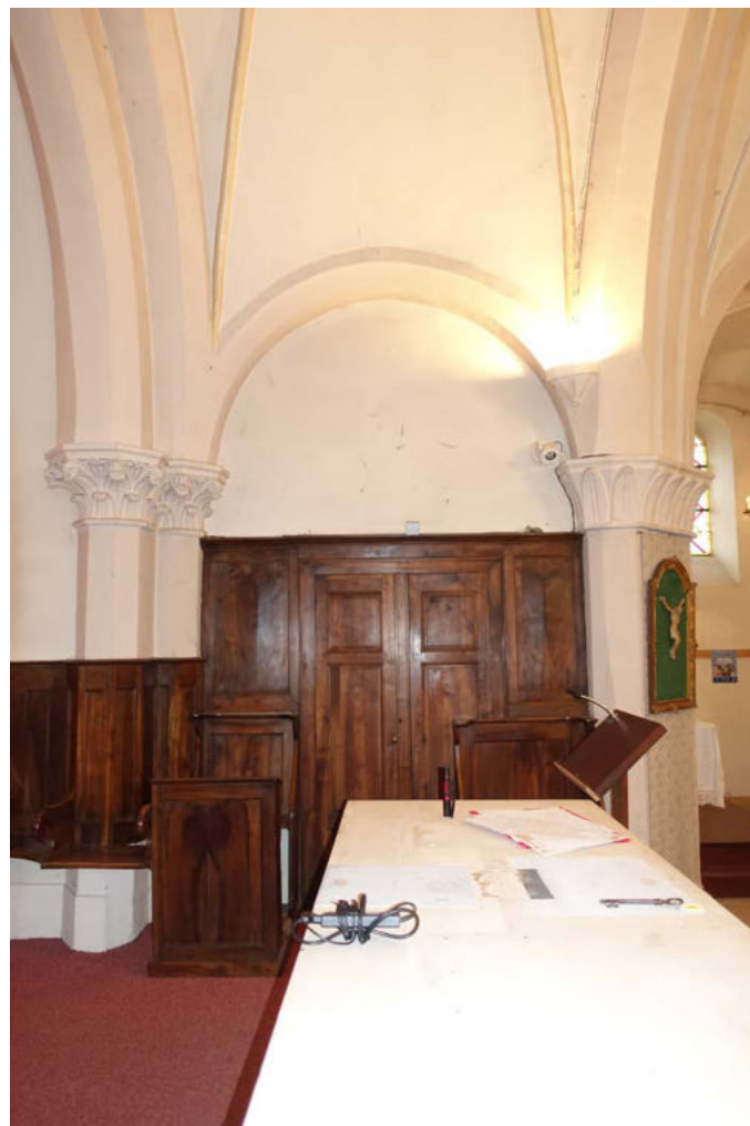
Mur Sud du choeur donnant sur le clocher - Revêtement vétuste
