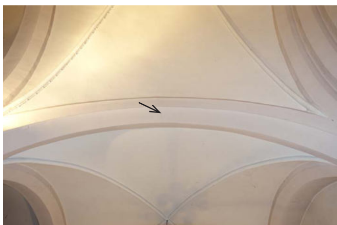
Nef centrale - Fissure de la voûte travée Ouest et travée centrale
