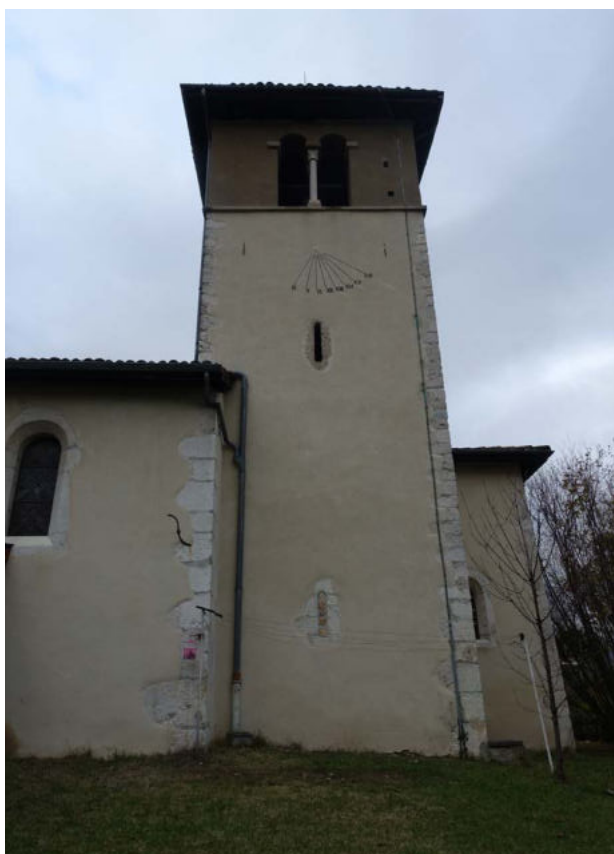
Façade Sud - clocher Importantes remontées capillaires
