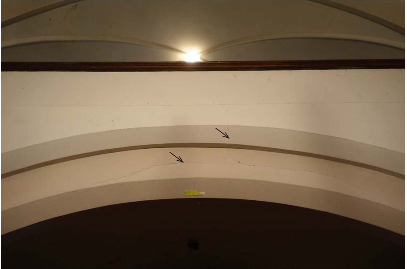
Fissuration de la voûte de la tribune
