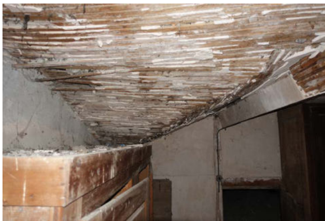
Étage du chœur - Plafond lattes plâtre très fortement dégradé
