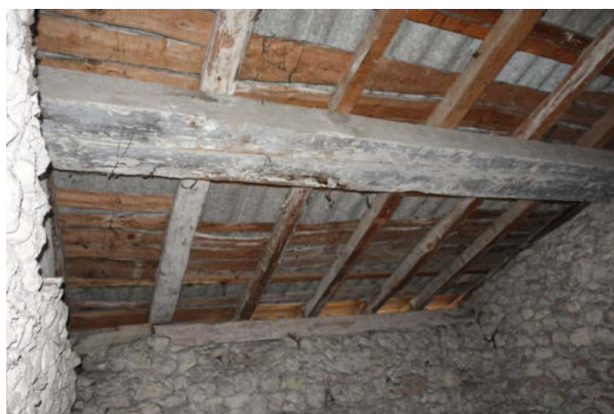
Panne intermédiaire pan Nord travée Ouest - infiltrations
