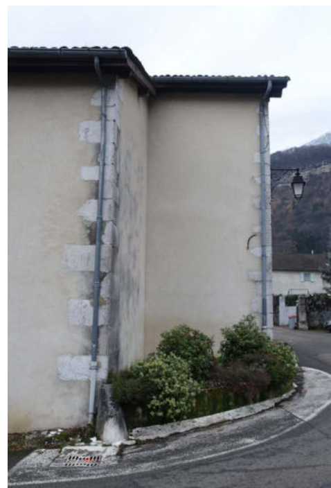
Façade Nord - porche d'entrée Remontées capillaires
