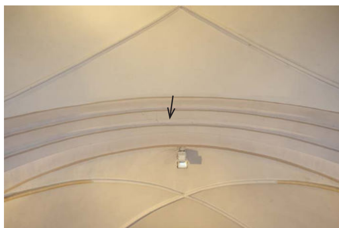
Nef centrale - Fissure de la voûte travée Est et chœur
