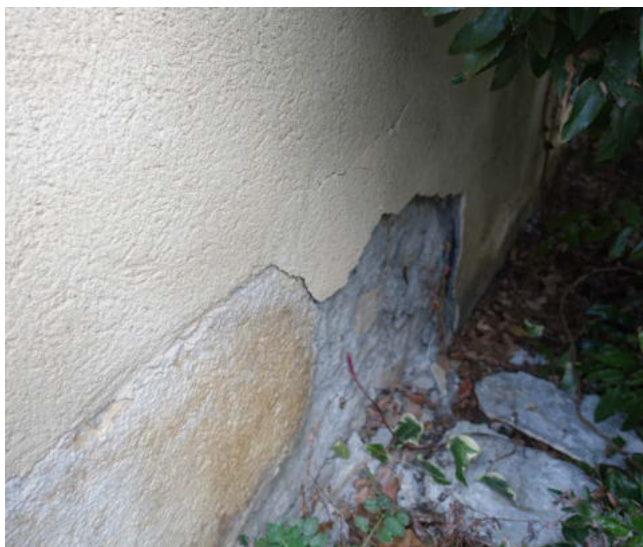
Façade Sud - porche d'entrée Forte dégradation de l'enduit en pied de mur au niveau de la jardinière
