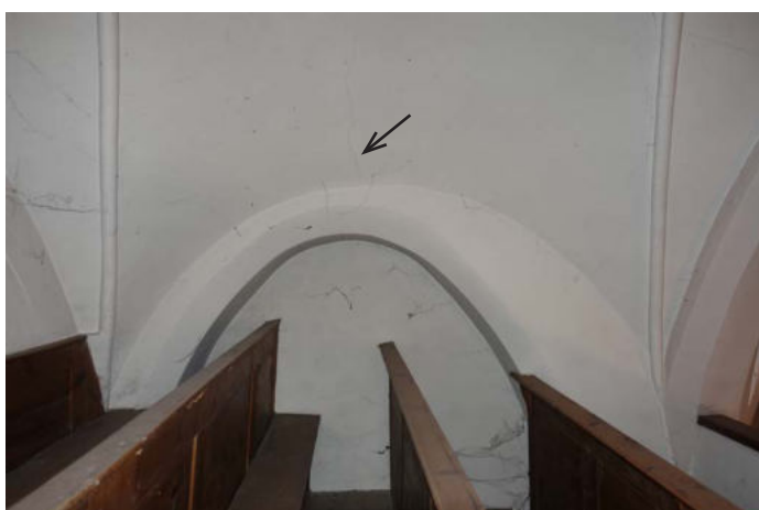
Tribune - mur Nord 1 fissure
