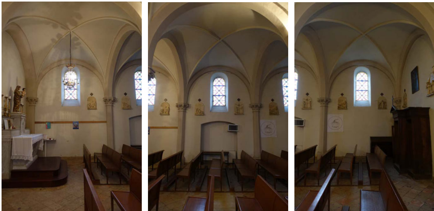
Vue de la nef centrale vers le bas-côté Sud - vitraux cassés travée centrale et Ouest
