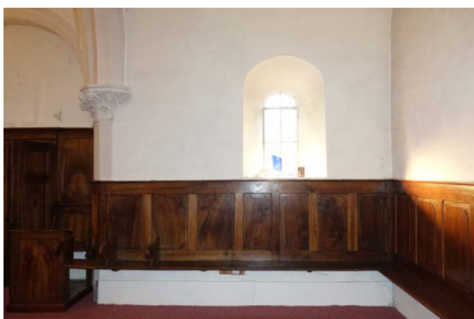
Mur Nord du choeur - Humidité en pied de mur et vitrage cassé, stalles en bon état
