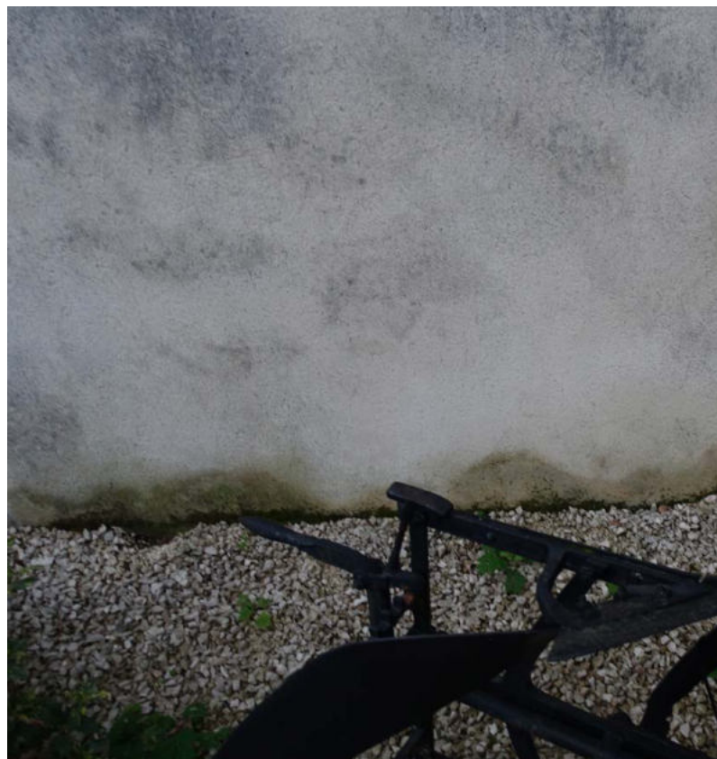
Façade Ouest - bas-côté Nord Pied de mur détrempe
