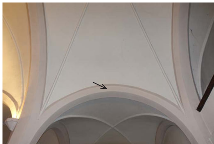
Travée Ouest - Fissure de la voûte entre nef centrale et bas côté Sud
