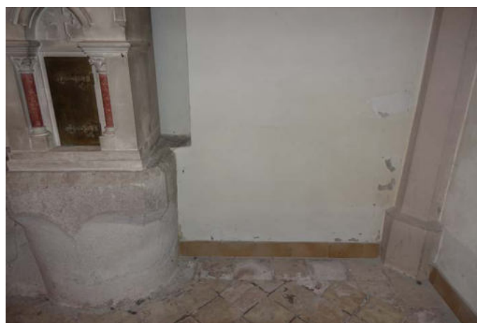
Mur Ouest bas côté Nord - Enduit pulvérulent, remontées capillaires (jardinière en façade)
