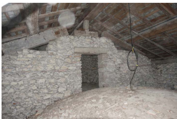
Panne intermédiaire pan Nord travée Ouest - infiltrations
