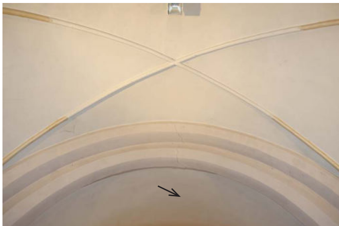
Nef centrale - Fissure de la voûte choeur
