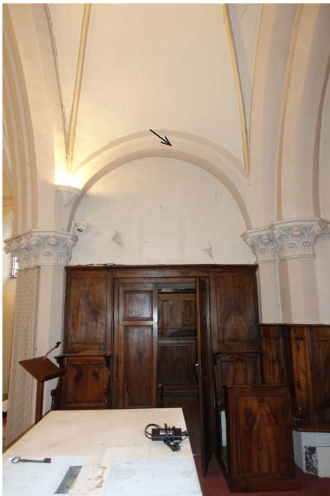
Mur Nord du choeur donnant sur la sacristie - Revêtement vétuste, fissure de la voûte
