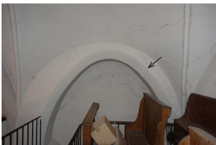
Tribune - mur Sud 1 fissure
