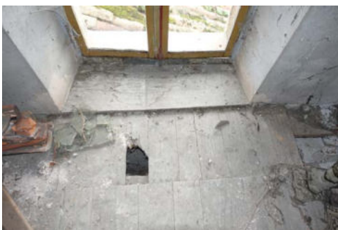
Étage du chœur - plancher bois dégradé : risque corporel
