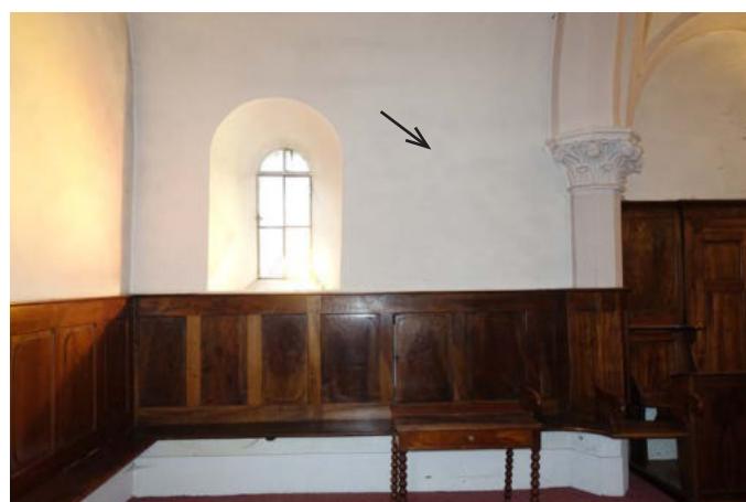
Mur Sud du choeur - Humidité en pied de mur et vitrage cassé, stalles en bon état, 1 fissure
