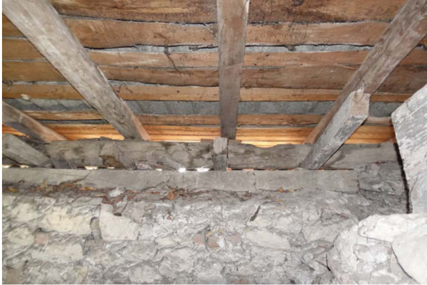
Panne sablière travée Ouest
