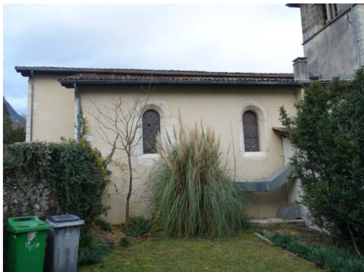
Façade Sud - 2ème et 3ème travée du bas-côté Remontées capillaires, arrachement chaufferie, vitreaux cassés
