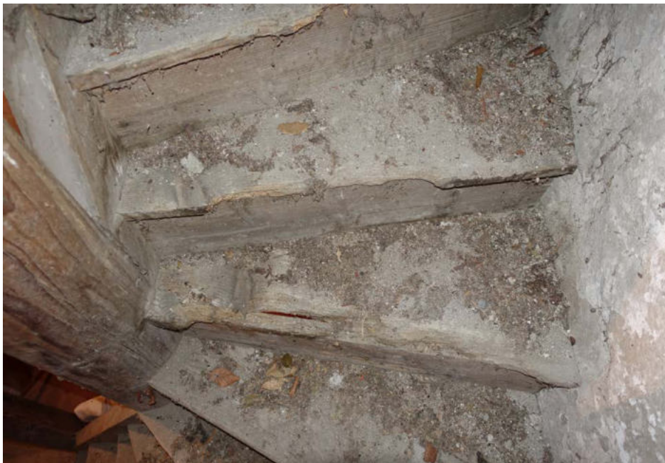
Clocher, escalier accès étage du chœur - Très dégradé, danger corporel
