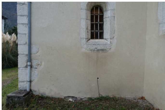
Façade Nord - clocher Importantes remontées capillaires
