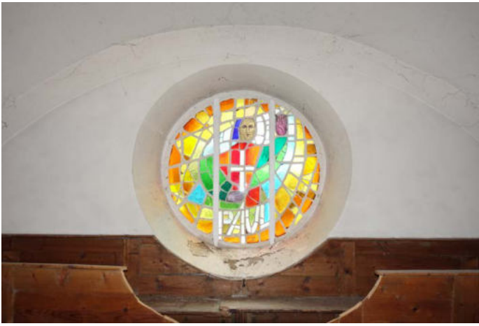
Tribune - mur Ouest 1 fissure au-dessus du vitrail ( int. et ext.)
