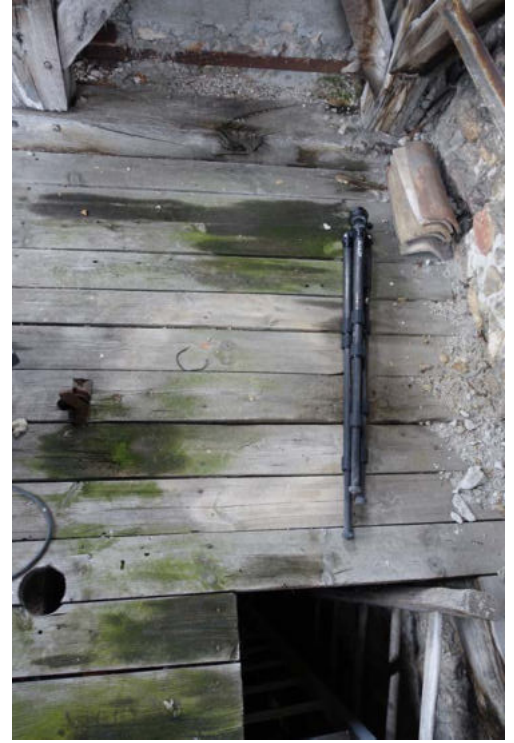
Plancher clocher - endommagé par les infiltrations
