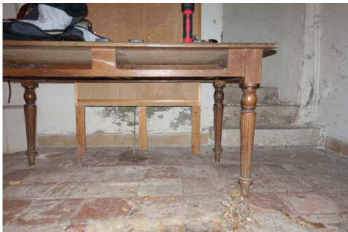
Porche d'entrée - Pied de mur Sud intérieur Enduit pulvérulent, remontées capillaires
