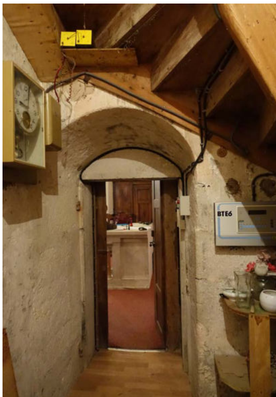
Clocher, mur séparatif avec chœur - Revêtement vétuste ; horloge et contrôle des cloches
