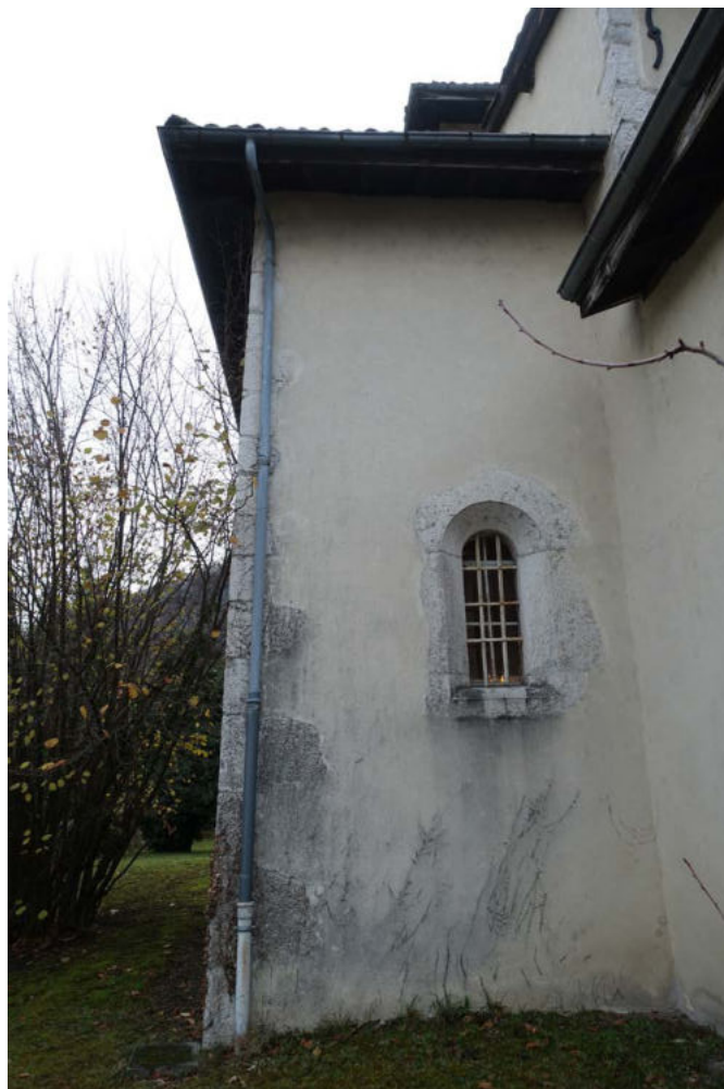
Façade Nord - chœur Taches sur l'enduit et remontées capillaires
