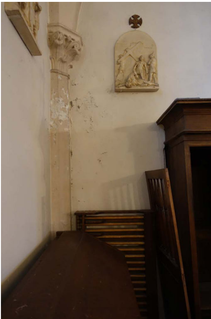
Angle Sud Ouest - Dégradation du revêtement
