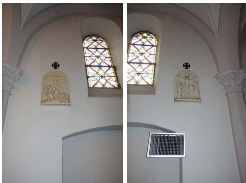
Mur Sud , travée centrale bas côtés - Plusieurs fissures de part et d'autre du vitrail
