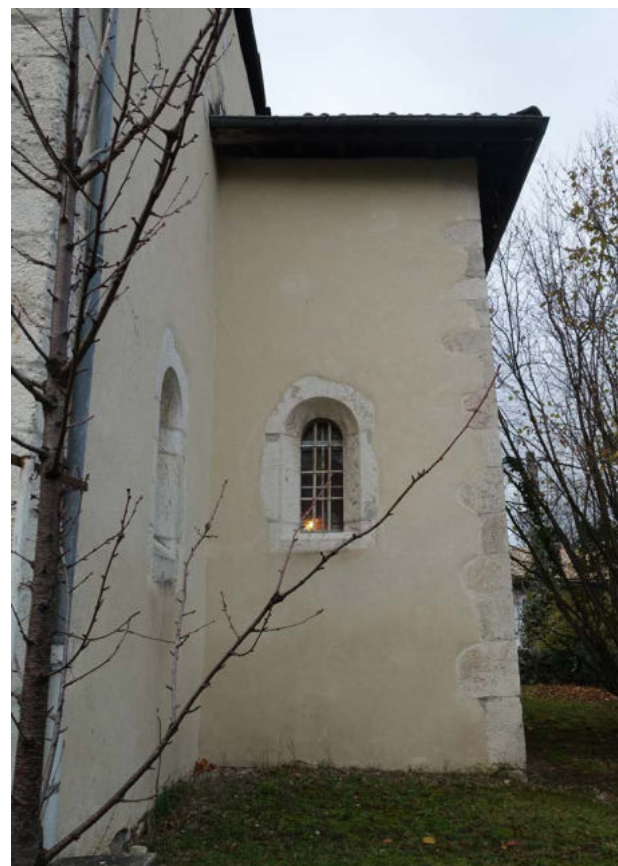
Façade Sud - chœur Importantes remontées capillaires
