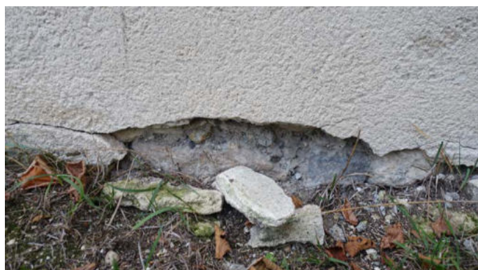
Façade Nord - clocher Altération enduit en pied de façade
