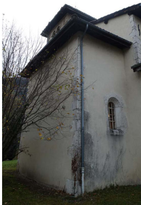
Façade Est et Nord - chœur Importantes remontées capillaires
