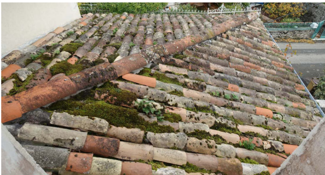
Toiture sacristie - hors d'usage
