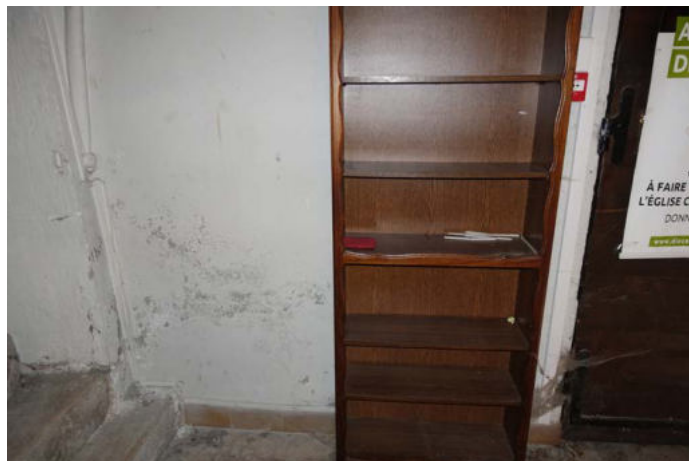
Porche d'entrée - Pied de mur Ouest Enduit pulvérulent, remontées capillaires
