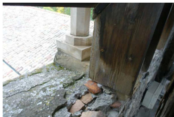
Clocher, mur Ouest - Support colonnes en molasse, appui dégradé
