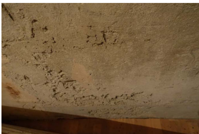
Clocher, mur Ouest - enduit pulvérulent en pied Enduit avec fresque au rdc, puis pierre apparente
