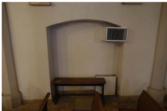
Mur Sud , travée centrale bas côtés Humidité en pied de mur, fissures
