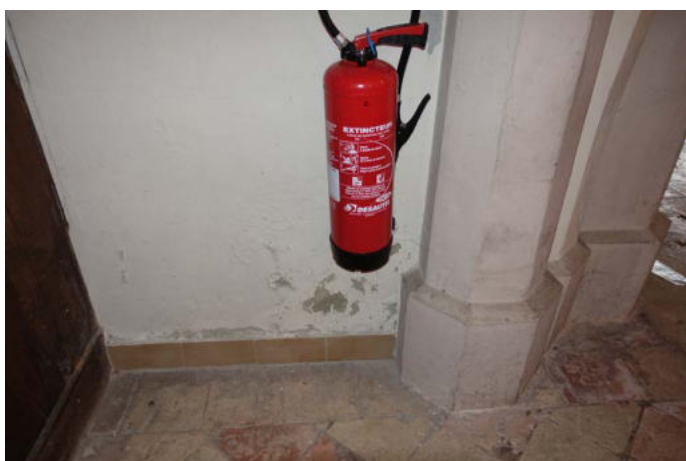
Mur Ouest bas côté Sud - Enduit pulvérulent, remontées capillaires (jardinière en façade)
