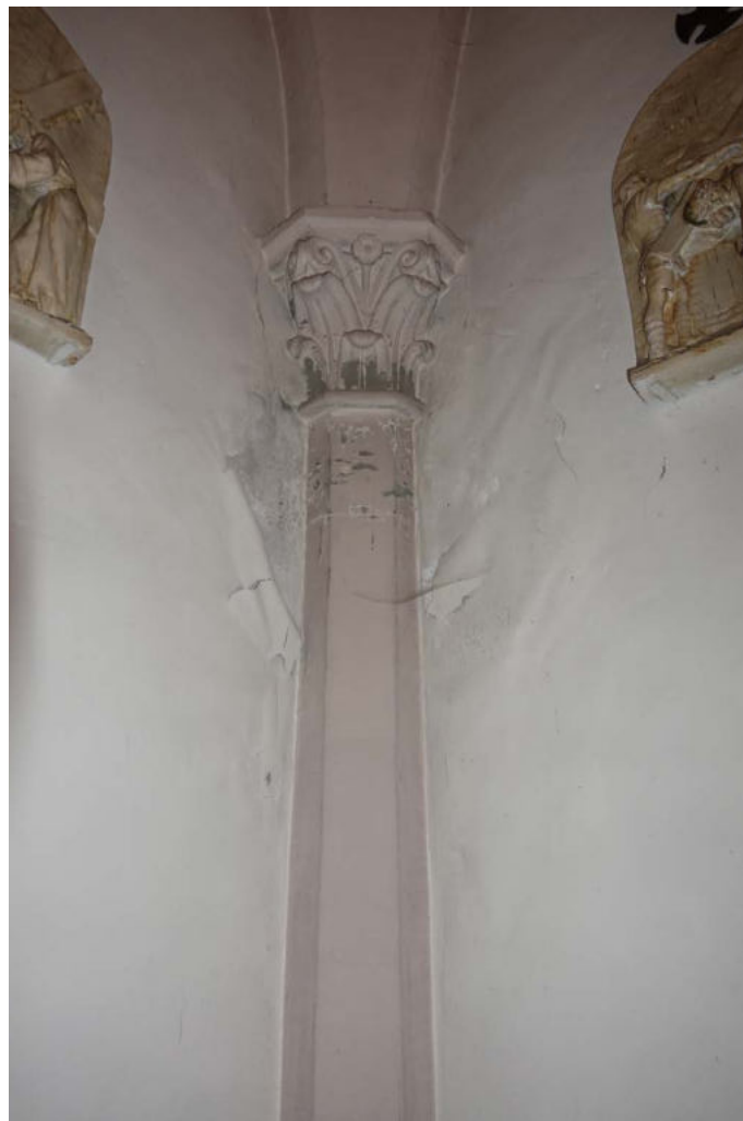
Angle Nord Ouest - Dégradation du revêtement, traces d'humidité importante (Fuite EP en façade)
