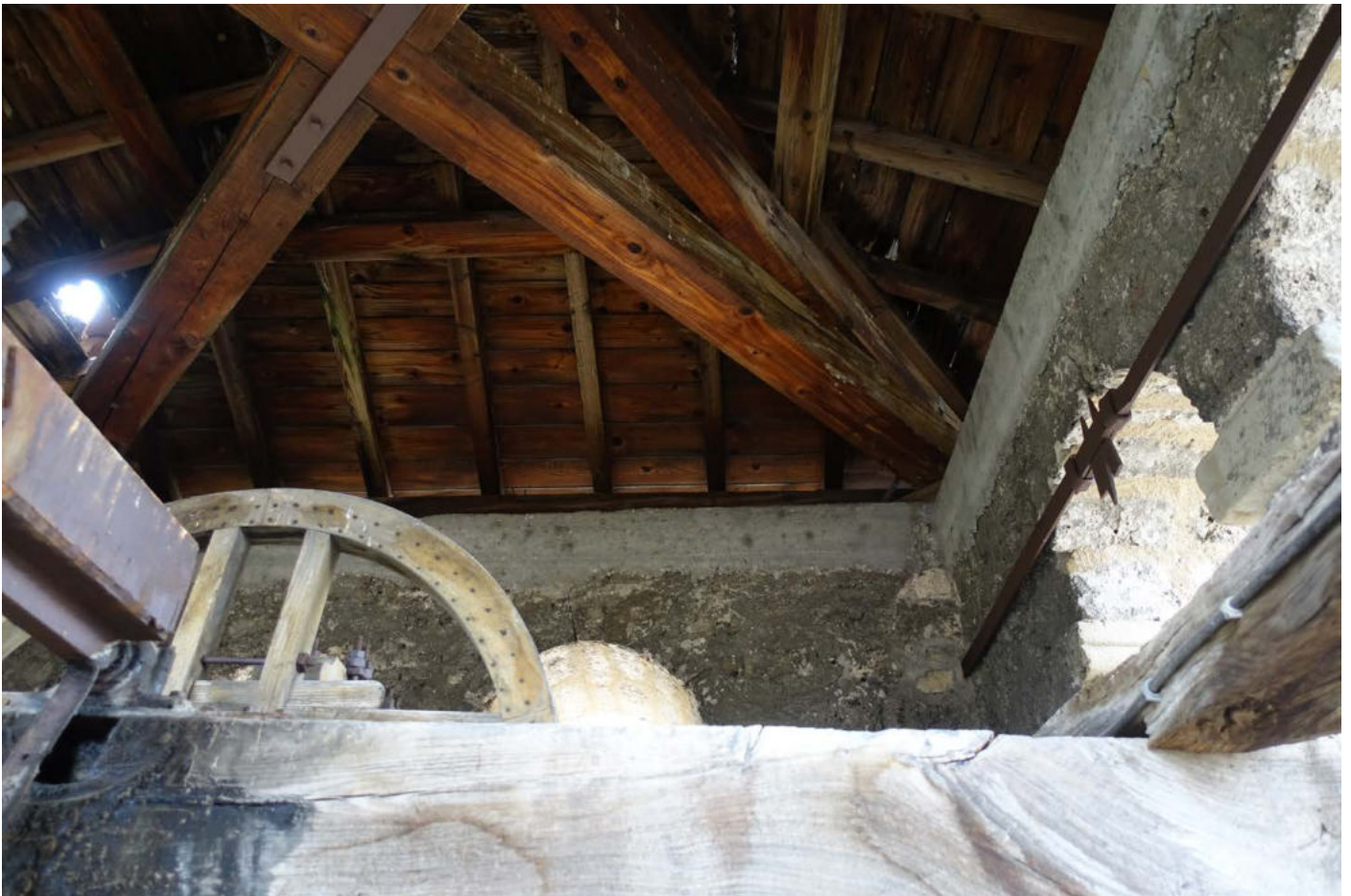
Charpente clocher Importantes infiltrations et dégradation de la charpente
