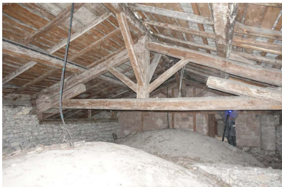
Ferme intermédiaire Est - infiltrations, dégradation pannes faitière et intermédiaire
