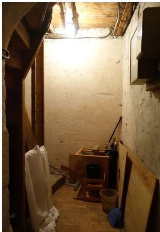
Clocher, mur Sud rdc - Enduit plâtre vétuste, humidité en pied de mur, fissure
