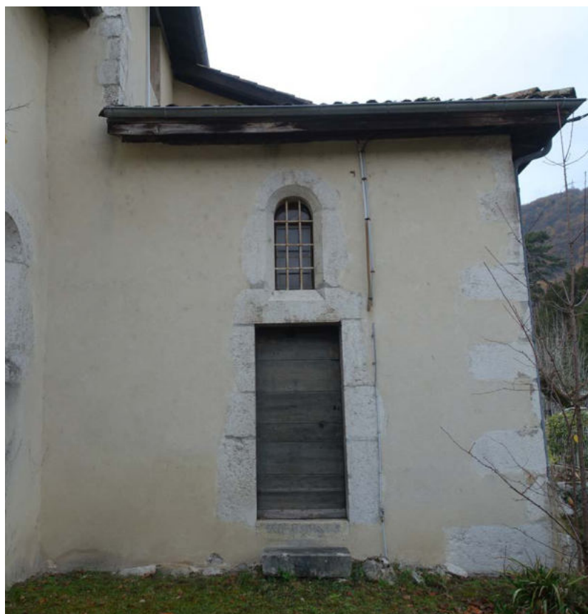
Façade Est - sacristie Importantes remontées capillaires
