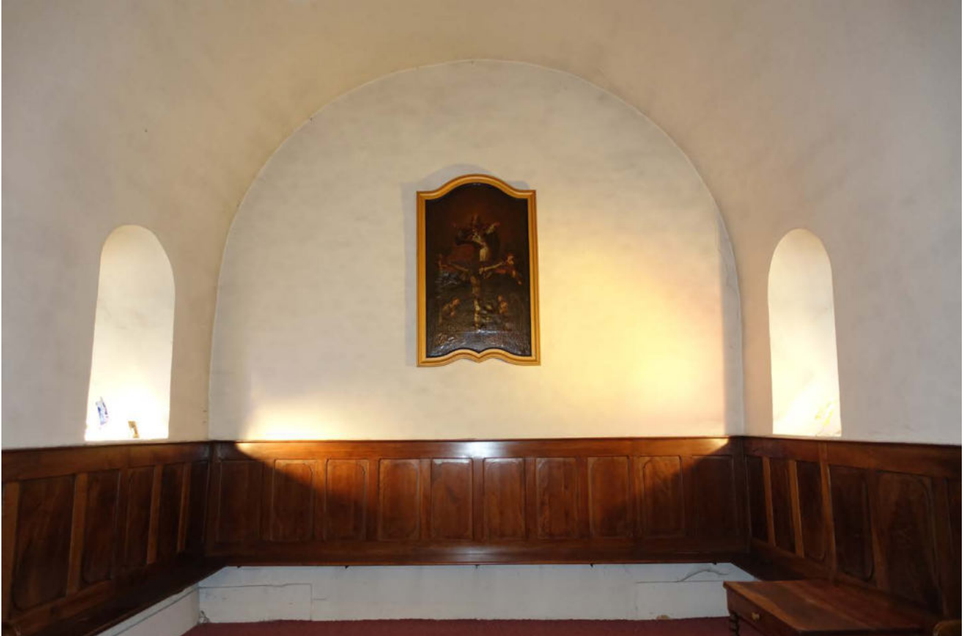
Mur Est du choeur - trame de verre sur la partie haute, humidité en pied de mur
