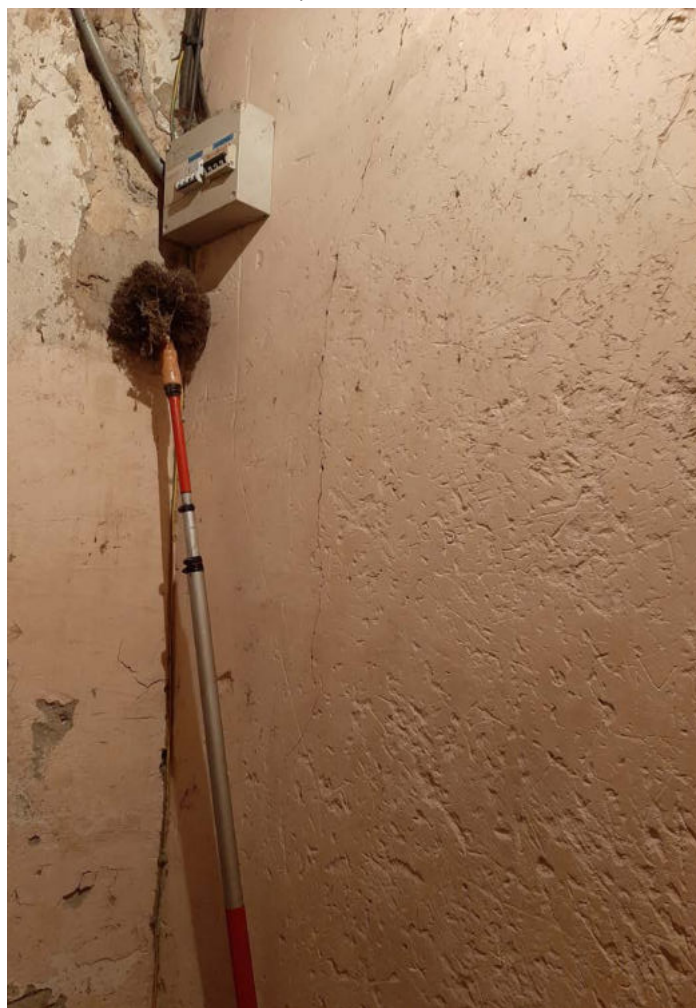
Clocher, mur Est - Enduit dégradé, fissure qui se prolonge à l'étage
