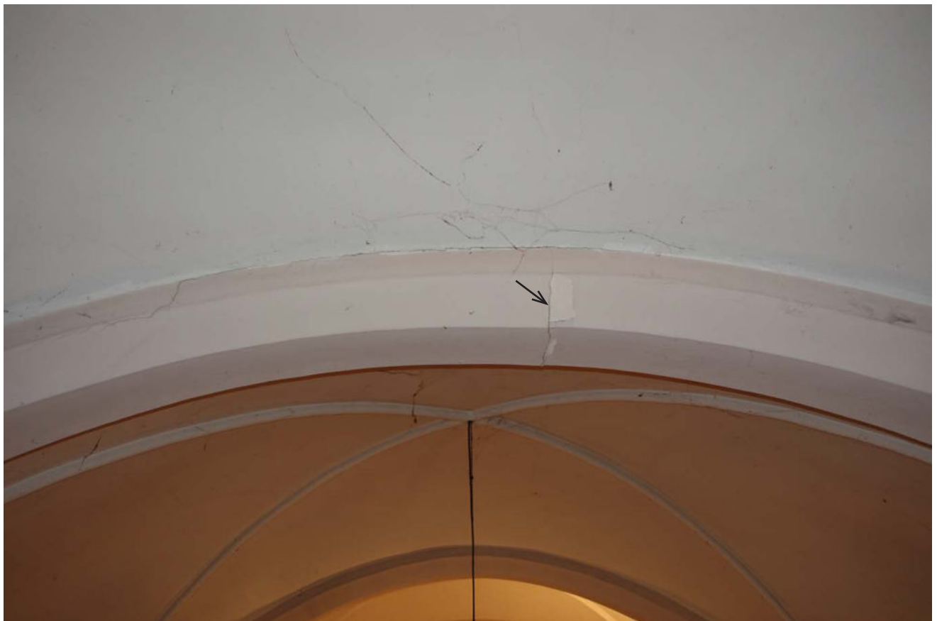
Fissuration de la voûte entre la tribune et la travée Ouest (vue depuis la tribune)
