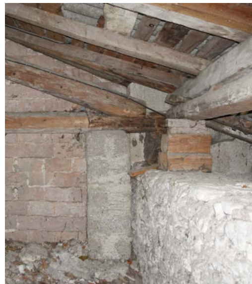
Reprise de la ferme Est par pilier béton et de la panne sablière Sud par des cales bois
