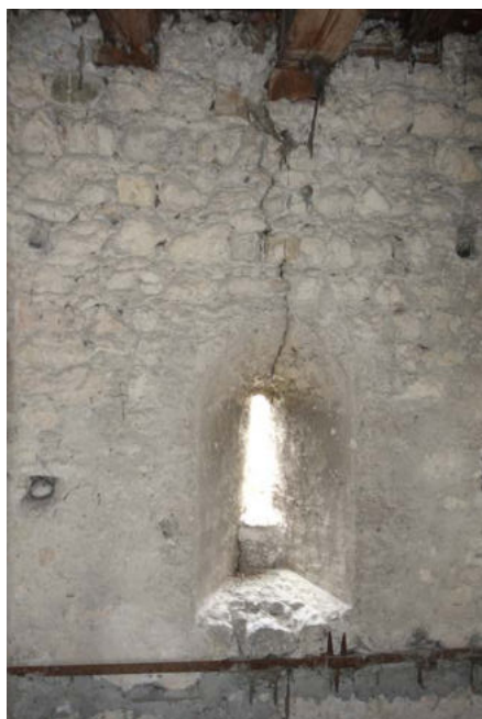
Clocher, mur Sud - 1 fissure verticale rebouchée en façade
