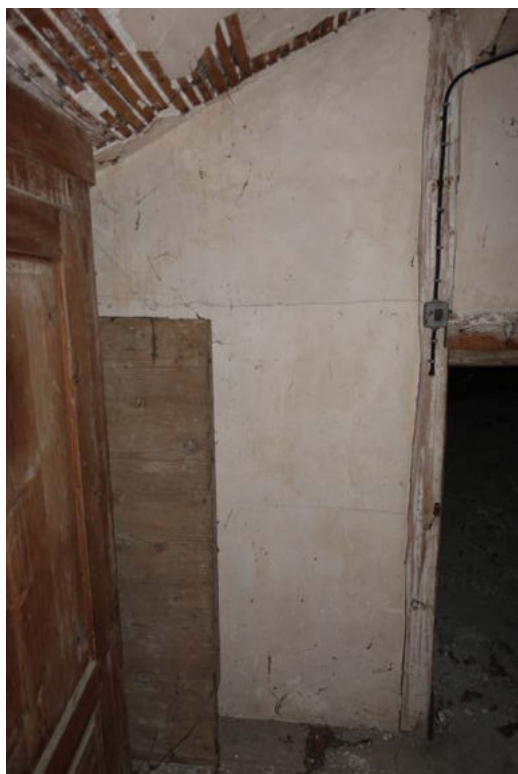
Étage du chœur, cloison séparative avec nef - Fissures horizontales
