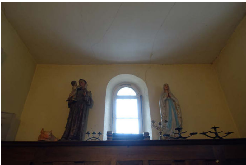
Sacristie, mur Nord - Plusieurs fissures qui se prolongent en plafond
